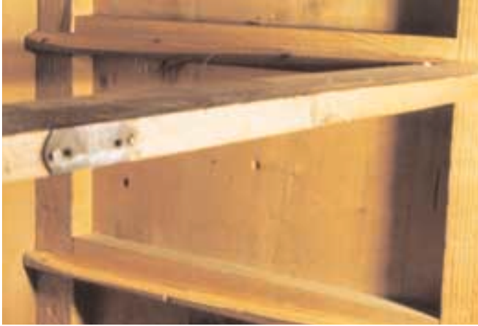
Abb. 8 Vorzustand – Laufleisten Mitte rechts
